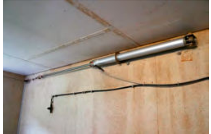
Der Druckzylinder schliesst via Seilzug die Fenster.
