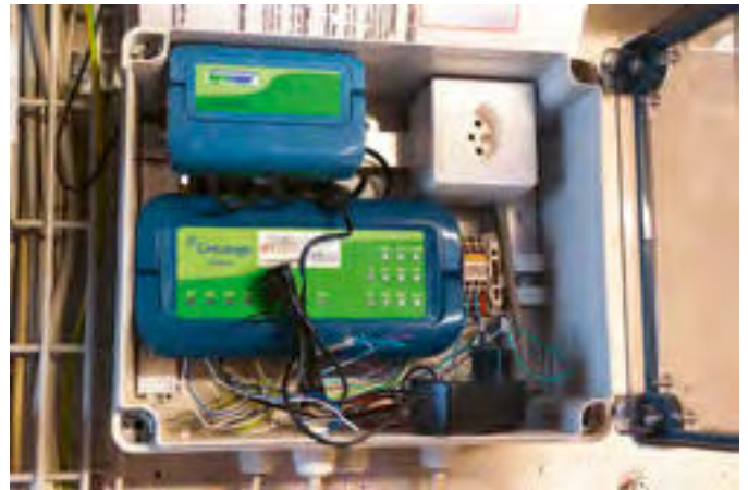
Telealarm-Zentrale. Für die Funktionsprüfung wird der Stecker gezogen.
